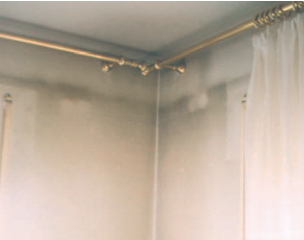
Die schwarzen Beläge traten in diesem Zimmer sechs Monate nach der Renovierung auf
